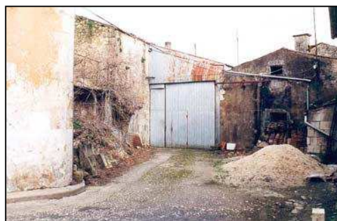
Bâtiments dégradés au sein de l'îlot.
